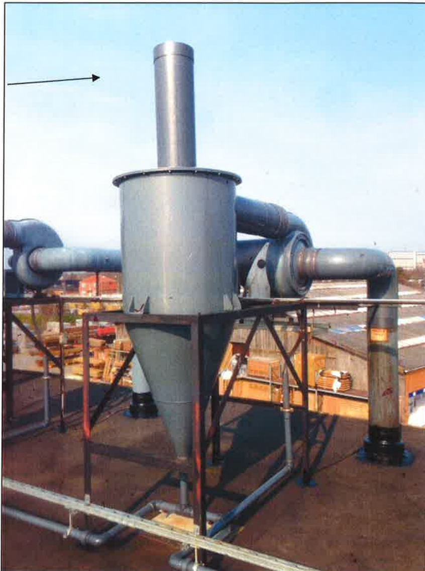
Figur 1 Eksempel på cyklon og afkast. Målestedet er placeret ca. 4 diameter over cyklonen - se pil.
